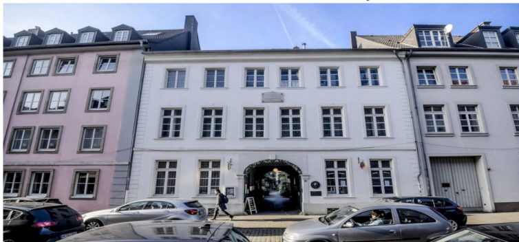
Das Schumann-Haus an der Bilker Straße wird saniert. Dort soll ein Museum entstehen.
